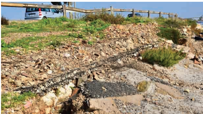
16. L'erosione del mare lungo la strada statale 195 (2018).
