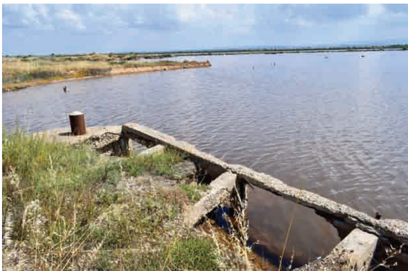
8. Strutture abbandonate e in disfacimento nella parte centrale della laguna (2018).
